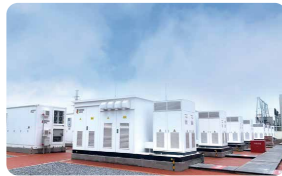
> 山东诸城100MW/200MWh储能项目
