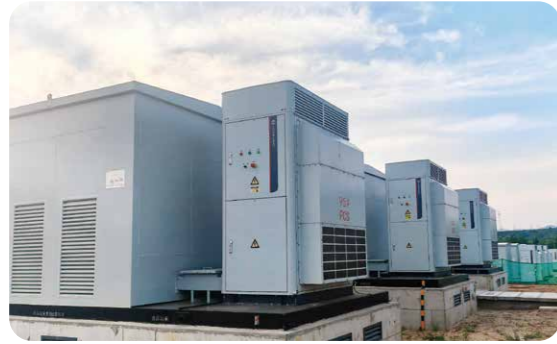
> 河北承德307MW/723MWh储能项目
