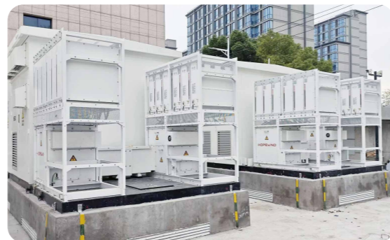
> 浙江嘉兴5MW/10MWh组串式储能项目
