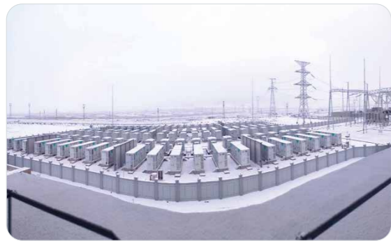
> 甘肃嘉峪关154MW/308MWh储能项目
