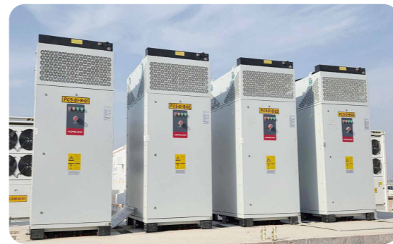
> 印度360MW光伏配储项目
