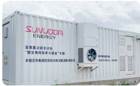
> 广东惠州3MW/6MWh 973国家重大项目
