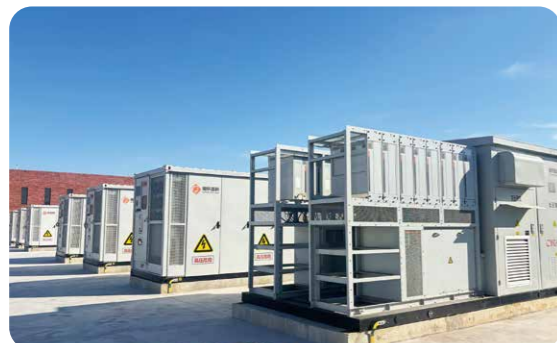
> 河北唐山25MW/50MWh组串式储能项目
