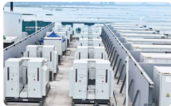
> 浙江乐清52.5MW/105MWh储能项目
