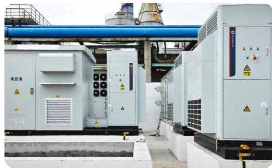
> 江苏江阴50MW/100MWh工商业储能项目
