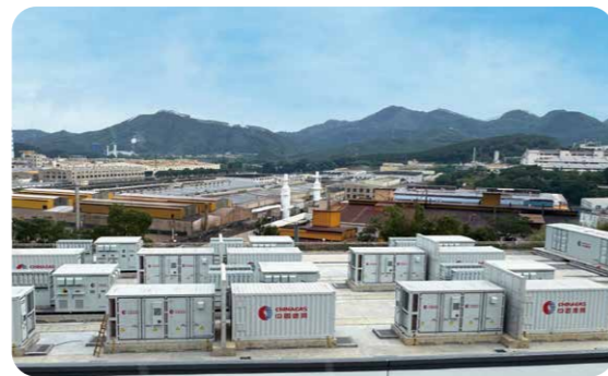
> 广东韶关25MW/50MWh组串式储能项目
