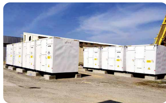
> 西班牙5.6MW/11.2MWh储能项目
