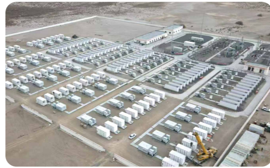
> 甘肃酒泉180MW/360MWh储能项目
