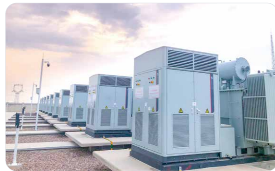
> 宁夏银川150MW/300MWh储能项目
