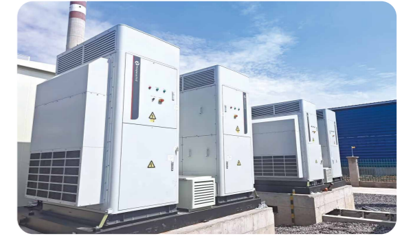
> 安徽阜阳25MW/50MWh储能项目
