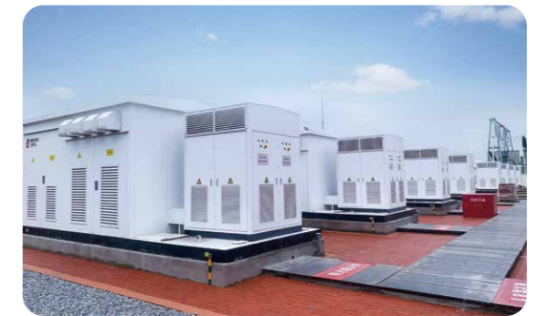
> 山东东明100MW/200MWh储能项目
