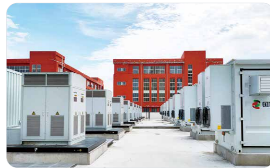
> 山东济宁100MW/200MWh储能调峰示范项目
