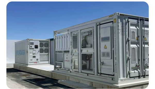
> 意大利摩德纳2.5MW/5MWh储能项目
