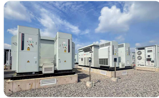
> 河北邯郸100MW/400MWh独立储能项目
