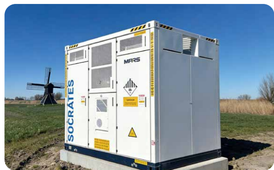
> 荷兰4.8MW/9.6MWh储能项目
