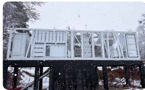
> 保加利亚11.25MW/45MWh组串式储能项目
