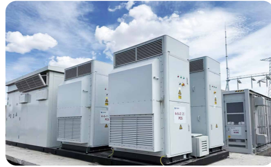
> 内蒙古锡林郭勒200MW/400MW构网型储能项目
