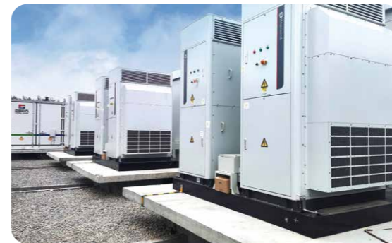
> 江苏涟水23MW/46MWh储能项目
