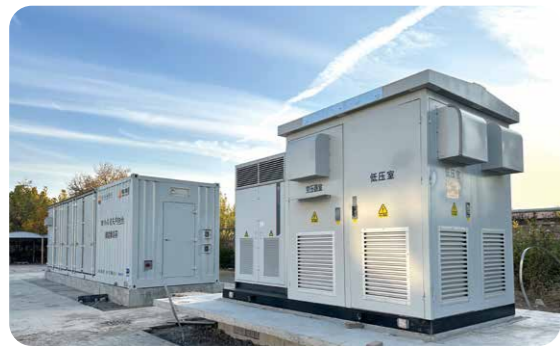
> 天津市大港油田1MW/1MWh钠离子电池储能电站
