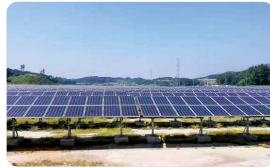
> 韩国12MW/36MWh光储项目
