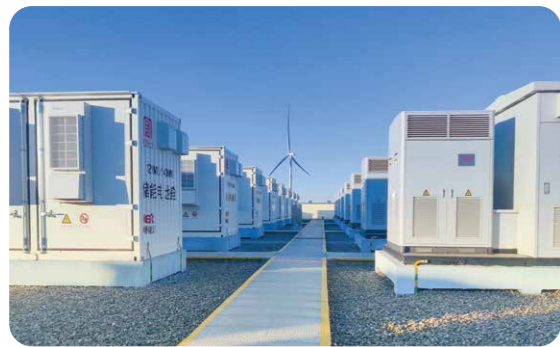
> 内蒙古阿拉善120MW/240MWh储能项目
