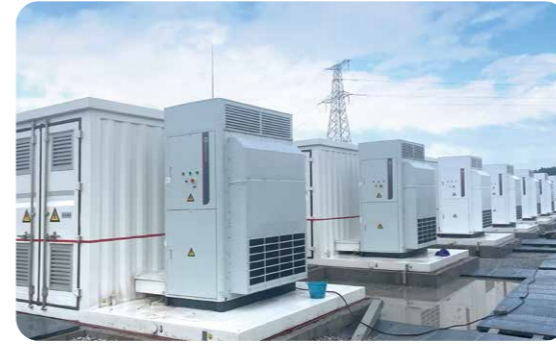
> 海南万宁25MW/50MWh储能项目
