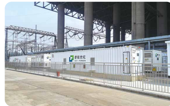
> 山西15MW/7.5MWh发电厂火储联合调频项目
