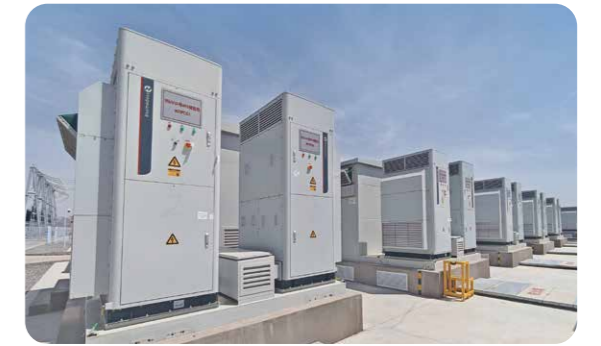
> 宁夏石嘴山100MW/200MWh储能项目
