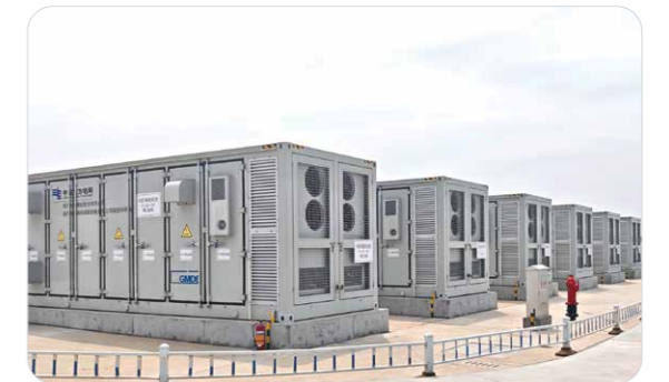
> 云南文山20MW/40MWh构网型储能项目
