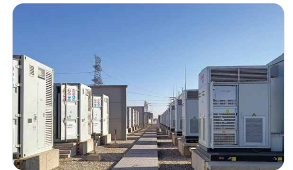
> 甘肃嘉峪关154MW/308MWh储能项目
