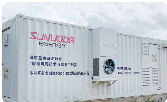
> 广东惠州3MW/6MWh 973国家重大项目
