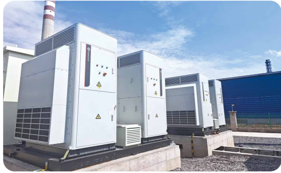
> 安徽阜阳25MW/50MWh储能项目
