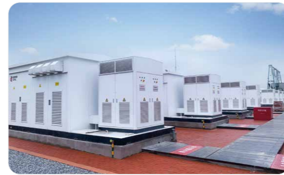
> 山东东明100MW/200MWh储能项目
