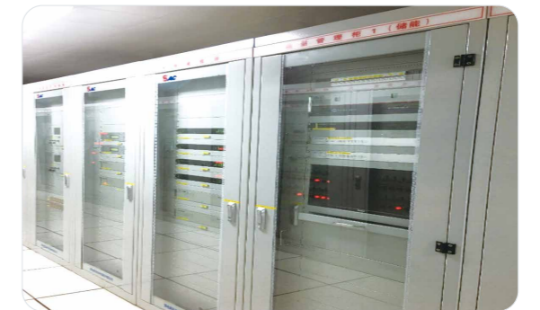
> 河南漯河风电配储EMS项目
