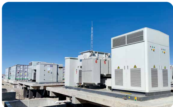
> 甘肃酒泉40MW/80MWh发电侧储能项目
