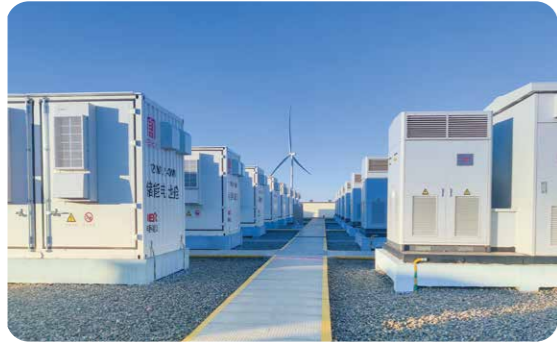
> 内蒙古阿拉善120MW/240MWh储能项目
