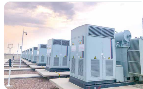
> 宁夏银川150MW/300MWh储能项目
