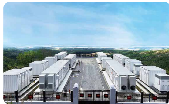
> 海南乐东25MW/50MWh发电侧储能项目
