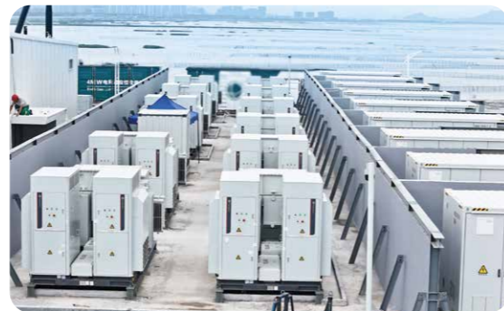
> 浙江乐清52.5MW/105MWh储能项目
