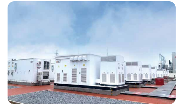
> 山东诸城100MW/200MWh储能项目
