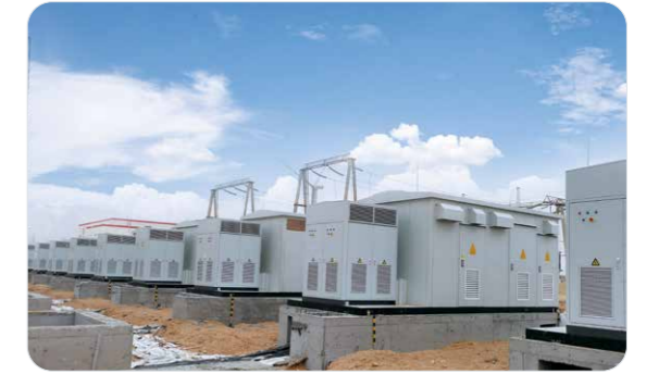
> 内蒙古阿拉善60MW/120MWh风电储能项目
