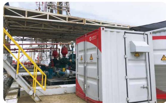
> 新疆克拉玛依工业储能项目
