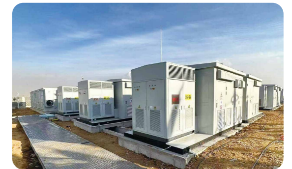
> 内蒙古呼伦贝尔50MW/100MWh风电储能项目
