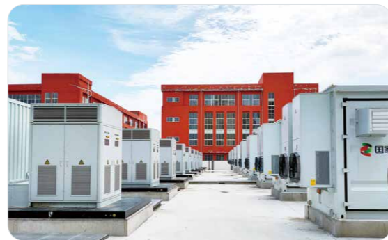
> 山东济宁100MW/200MWh储能调峰示范项目
