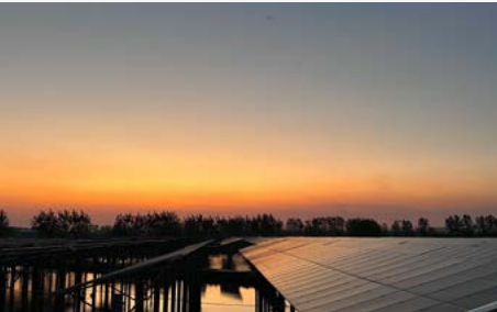
湖北浠水 160MW 渔光互补项目现场图
