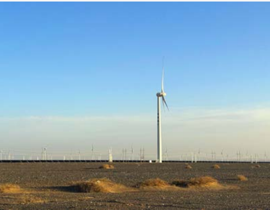
甘肃省百兆瓦级全构网型风场
