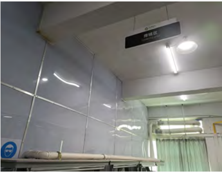
空气管道净化装置现场
